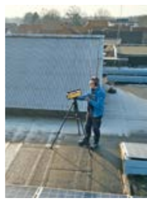
Ein Mitarbeiter der Firma Drescher Solar bei der Fehlerortung.
